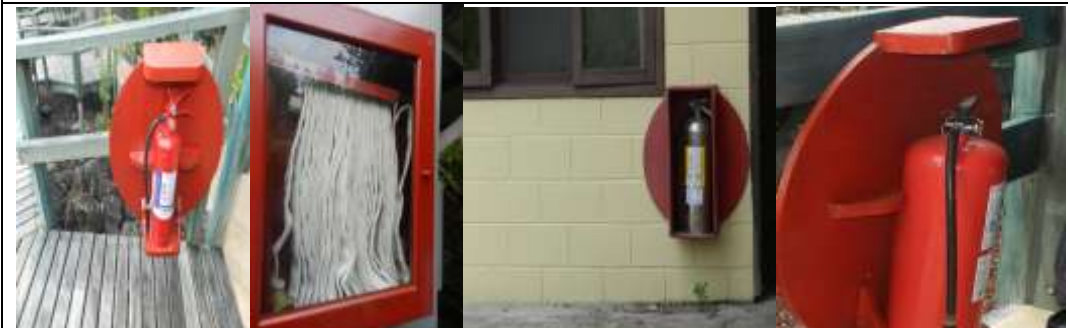
Equipo de protección de incendios
