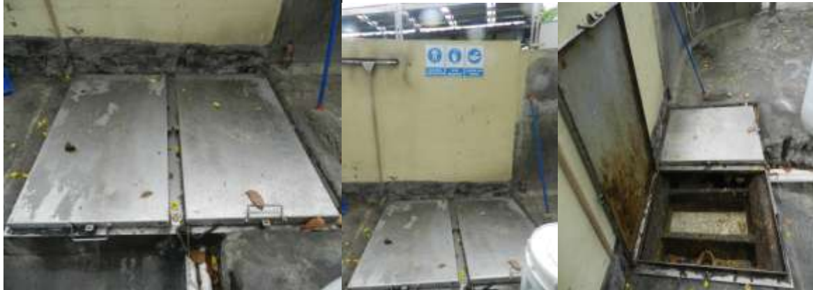
Área de Tratamiento de aguas residuales
